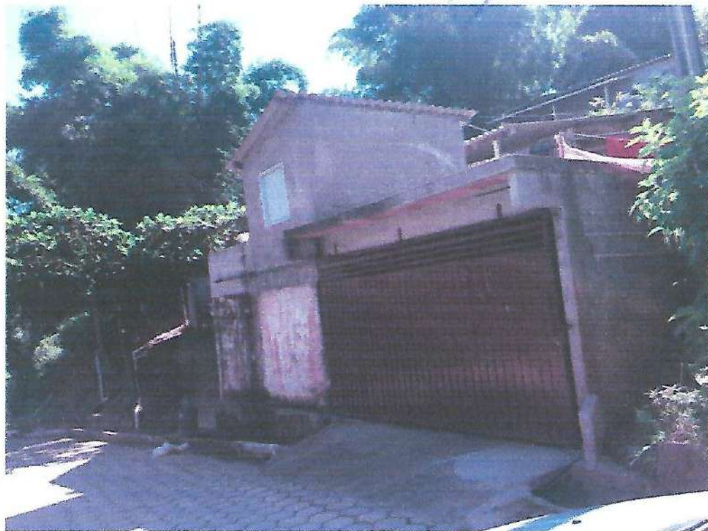
Imóvel localizado na Rua São Bartolomeu, S/N – Bairro do Rocio. Grau de Risco: Leve – com ressalva de monitoramento.
