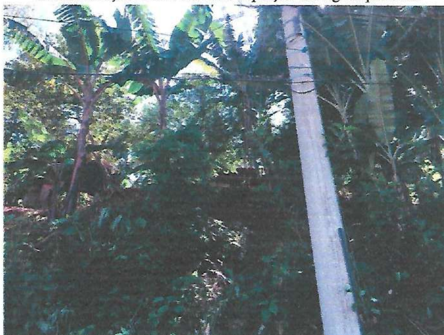
Imóvel localizado na Rua São João, S/N, Bairro do Rocio. Grau de risco: grave, com recomendação de monitoramento e medidas públicas preventivas.
