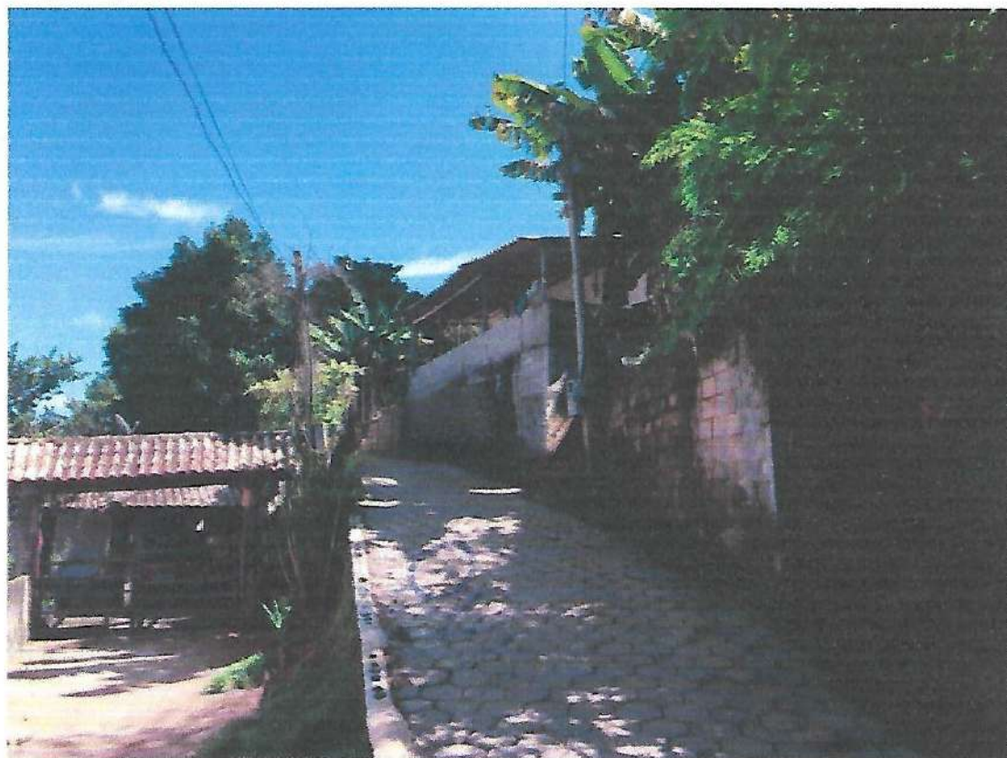
Imóvel localizado na Rua São João, S/N – Bairro do Rocio Grau de risco do imóvel: leve, devendo ser feito o monitoramento.
