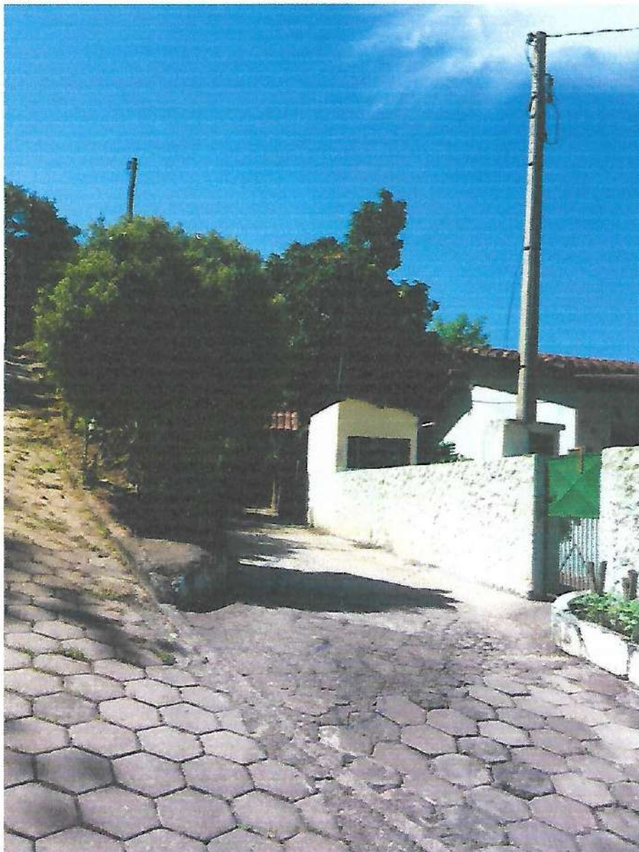
Imóvel localizado na Rua São João, S/N, Bairro do Rocio Grau de risco: leve, com recomendação de monitoramento.
