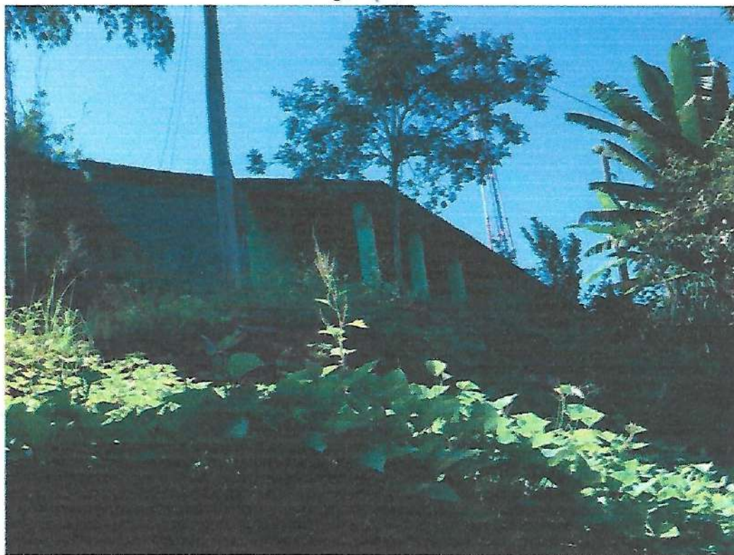
Imóvel localizado na Rua São João, S/N – Bairro do Rocio Grau de risco do imóvel: Grave, devendo ser feito o monitoramento capitalização de águas pluviais.
