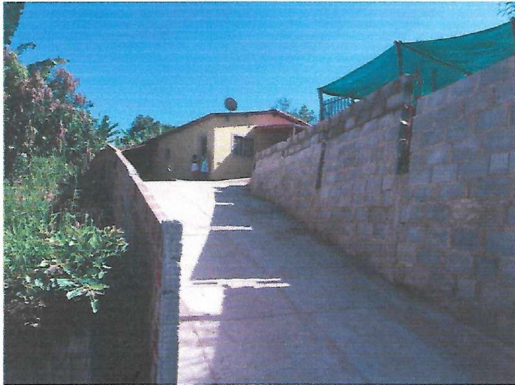
Imóvel localizado na Rua São Bartolomeu, S/N – Bairro do Rocio. Grau de Risco: leve – com ressalva de monitoramento
