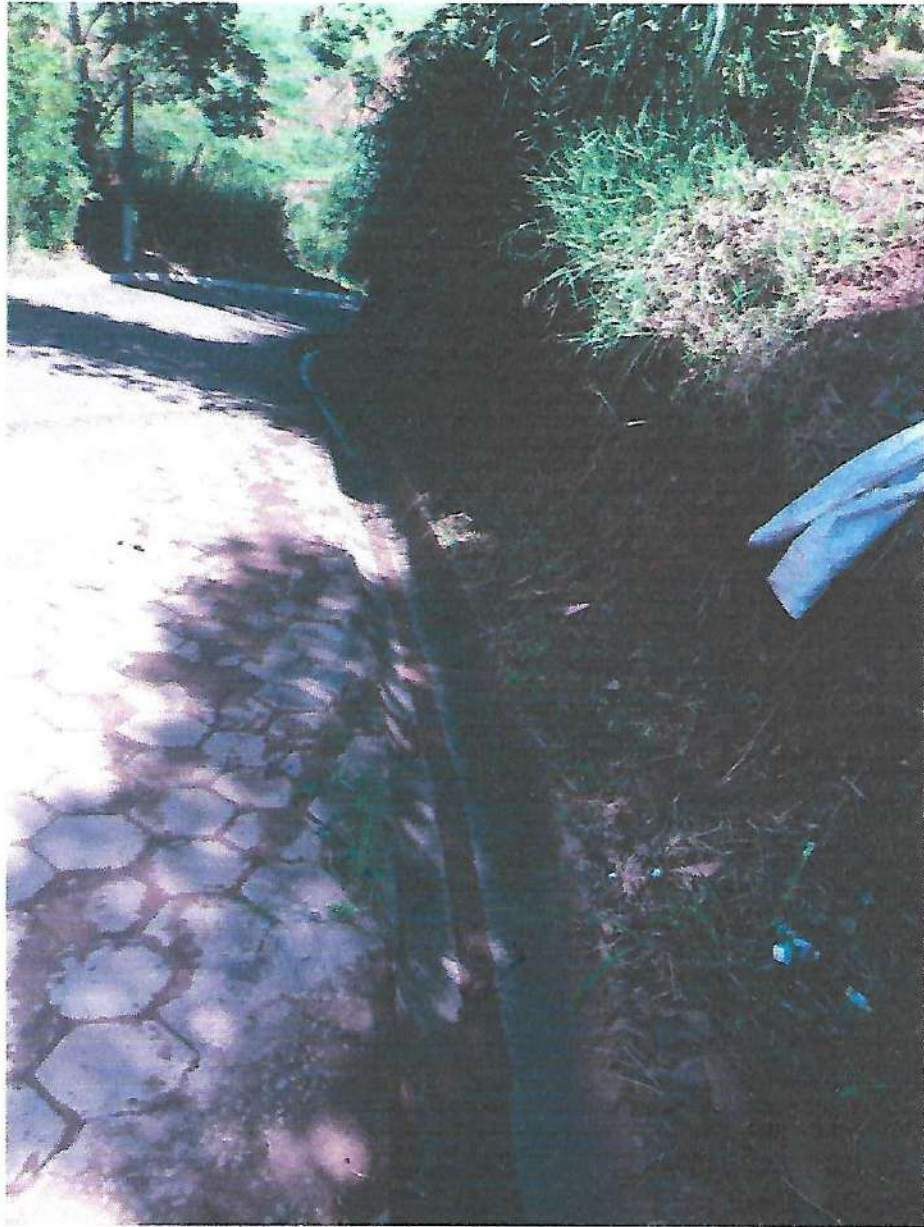
Sistema de captação de águas pluviais da Rua São Mateus X Rua São Tiago
