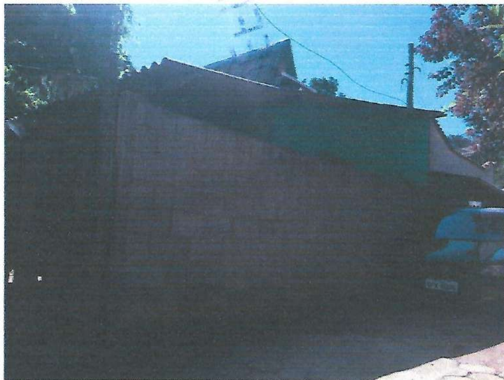
Imóvel, S/N, Centro do Bairro do Rocio. Grau de Risco: Médio – com ressalva de monitoramento.
