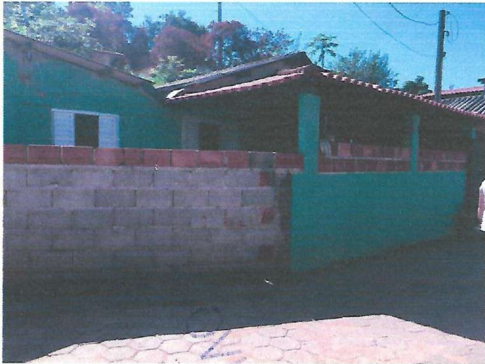
Imóvel localizado na Rua São Mateus, S/N – Bairro do Rocio. Grau de Risco: leve – com ressalva de monitoramento
