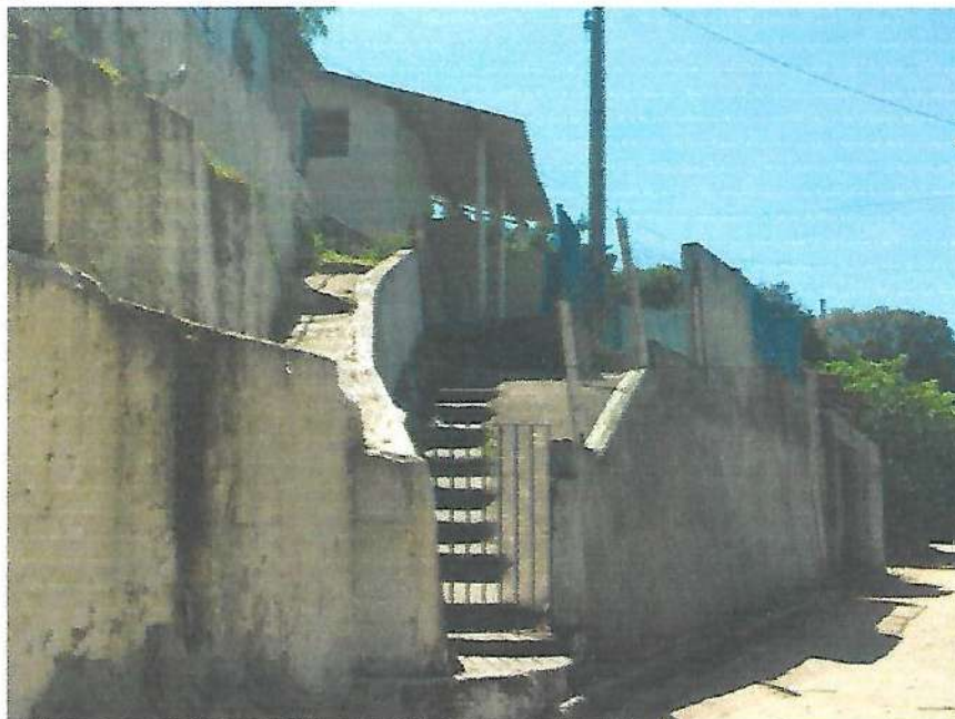
Imóvel localizado na Rua São Pedro, S/N, Bairro do Rocio Grau de Risco: leve, com recomendação de monitoramento.
