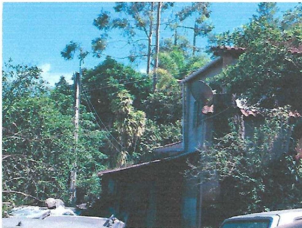
Imóvel localizado na Rua São João, S/N – Bairro do Rocio Grau de risco: médio, devendo ser feito o monitoramento capitalização de águas pluviais.
