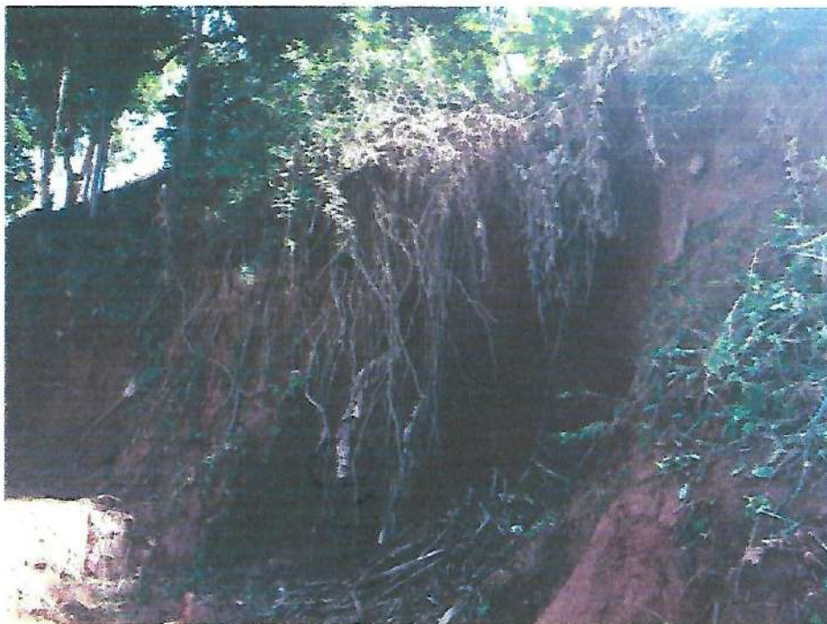
Erosão causada pelas chuvas – Rua São João Recomendação: Deve ser feito captação das águas pluviais.
