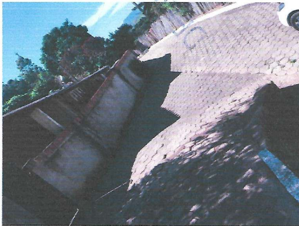
Imóvel localizado na Rua São Mateus , S/N – Bairro do Rocio. Grau de Risco: leve – com ressalva de monitoramento
