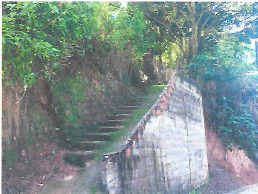
Imóvel localizado na Rua São Pedro, S/N, Bairro do Rocio Grau de Risco: Médio, com recomendação de monitoramento.
