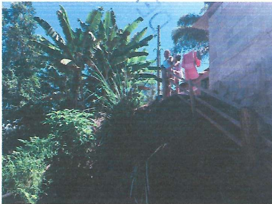
Imóvel localizado na Rua São João, S/N – Bairro do Rocio Grau de Risco: Grave, devendo ser tomadas medidas públicas para estabilização da área.
