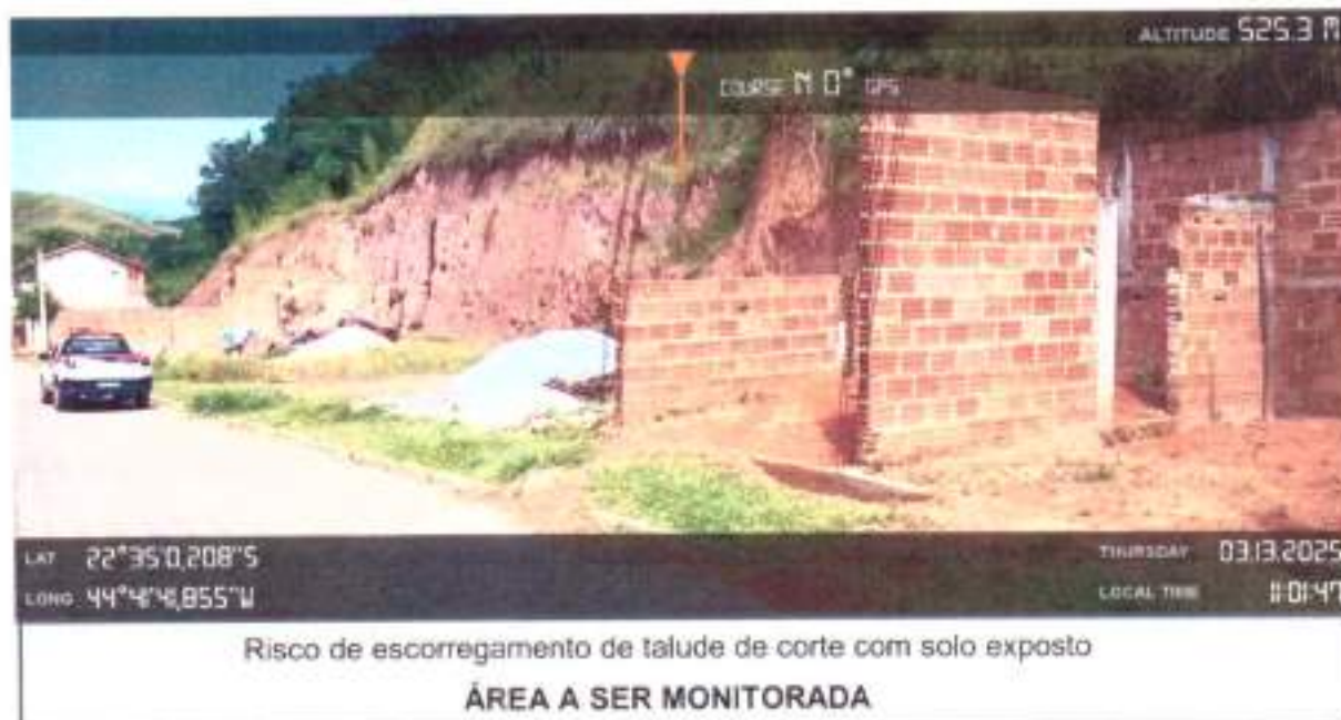
Imagem 12 e Área 5 (IMG-20250313-WA0003.jpg)
