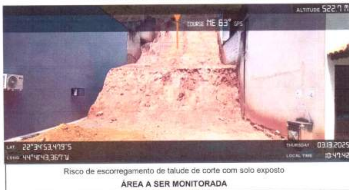
Imagem 09 e Área 4 (IMG-20250313-WA0010.jpg)
